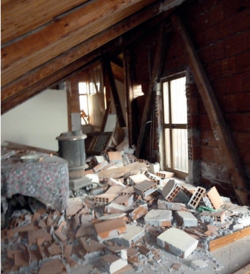
Figura 5. Crollo di una parete a casa del signor Roberto
